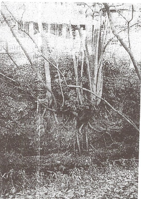
玉川上水の土の法面から伸びる雑木。木の重みで崩れ落ちる場所があちこちで見ることができる
